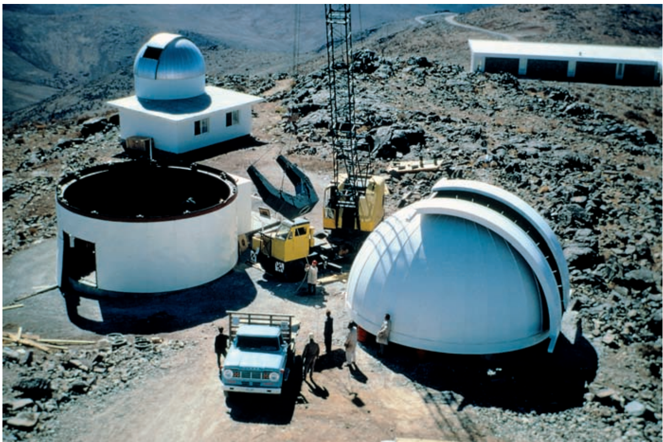
Im September 1968 wird das 1-Meter-Teleskop auf La Silla aus seiner provisorischen Kuppel in das fertig gestellte Gebäude verlegt. Weil Teleskop und Montierung (am Kran) nicht durch den Kuppelspalt passen, muss kurzerhand die ganze Kuppel abgehoben werden. Im Hintergrund das Gebäude des Bochum-Teleskops.
